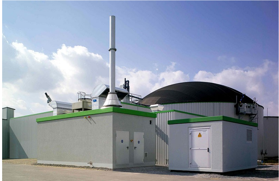
FIGURA 1 – IMPIANTO DI PRODUZIONE BIOGAS: IN PRIMO PIANO IL CONTAINER DEL MOTORE E LA CABINA ELETTRICA (FOTO SCHMACK BIOGAS SRL)
